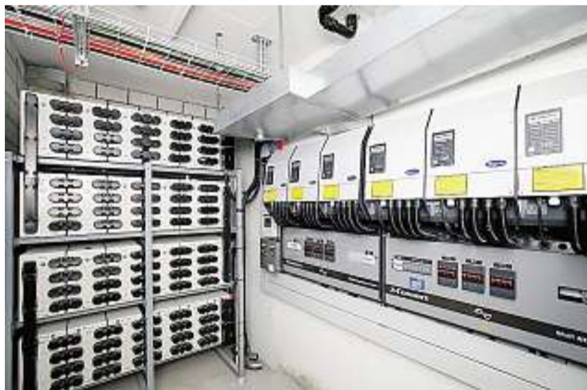
Der Batterieraum befindet sich im Keller des Hauses.
