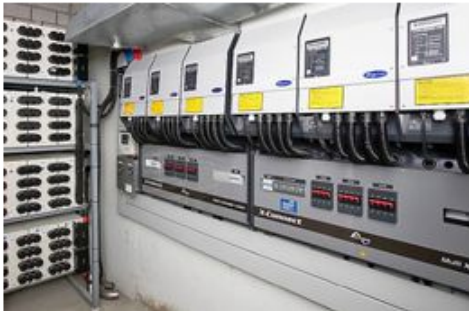
Die Batterien zum Speichern des Solar- und Kraftwerkstroms befinden sich im Keller.
